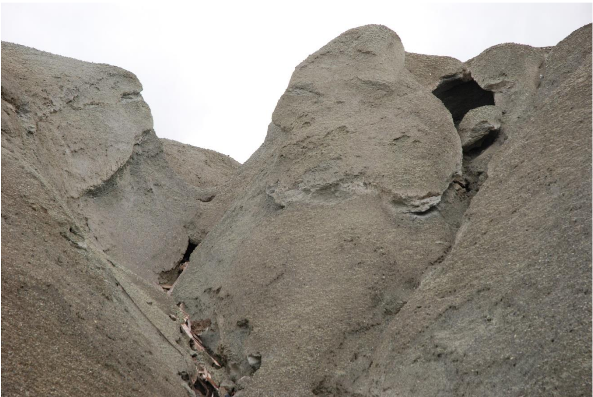
Figure 8 : Ravinement, érosion sévère, au sommet d'une halde de résidus
