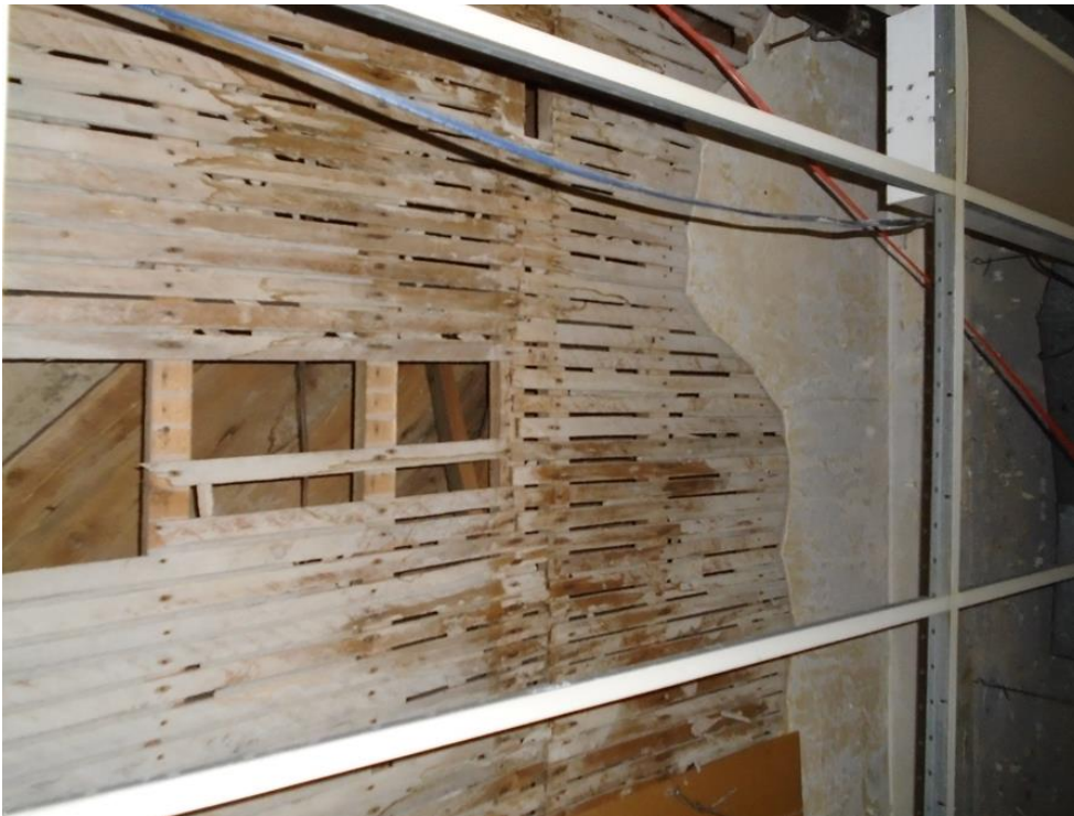
Figure 3 Les plâtres sont réputés contenir de l'amiante. Il faut présumer que les matériaux de construction d'un certain âge contiennent de l'amiante, quitte à démontrer qu'ils n'en ont pas.
