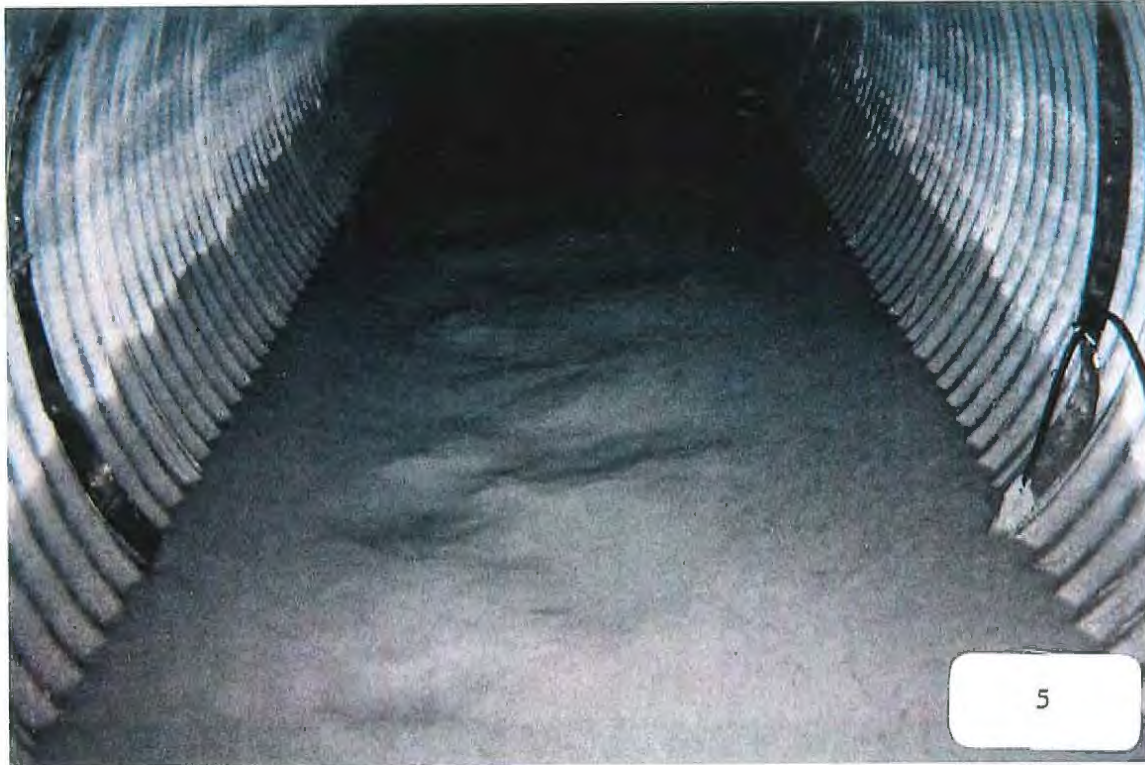
J.M.2 Flotote dans la conduite
