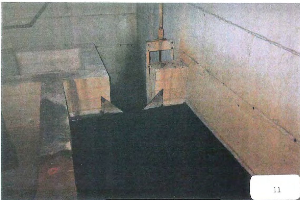
J.M.4 Déversoir en V 90°
