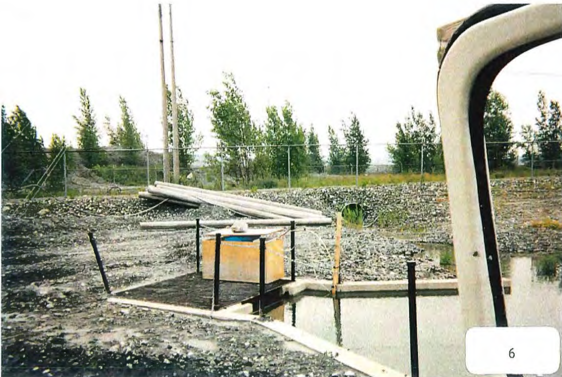
J.M.3 Sortie du bassin de sédimentation
