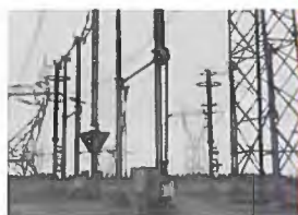
RPTC : un nouvel automatisme mis en service dans les postes.
