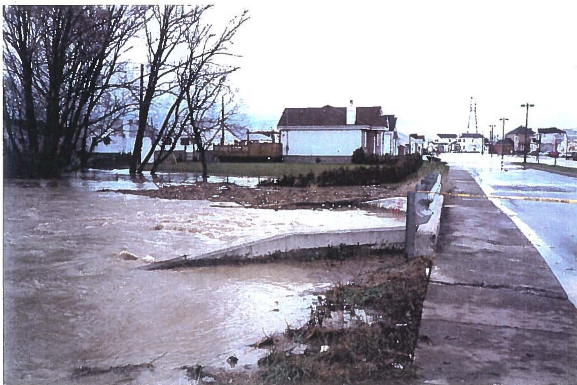
Événement du 8 et 9 novembre 1997 6 - Vue aval / pont du boul. des Écluse
