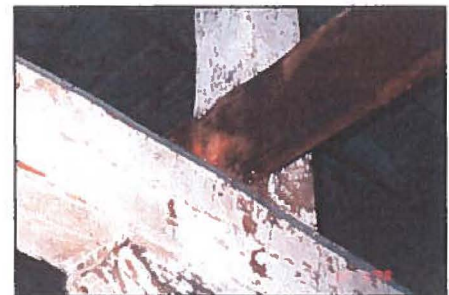
Photo # 18.- Éclisse manquante dans une solive de contreventement;
