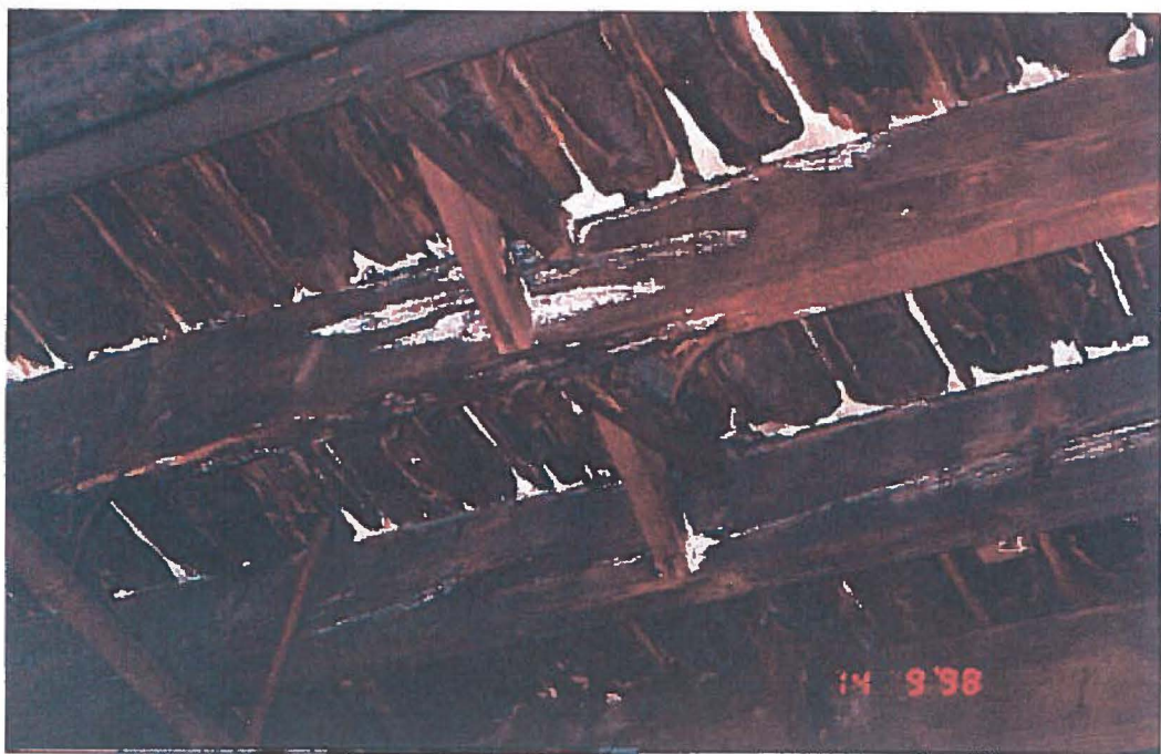
Photo 20: Section D: détails du toit (pourriture avancée).
