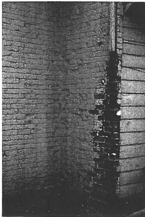
Figure 7. Briques endommagées par le gel à la suite d'un manque d'entretien
