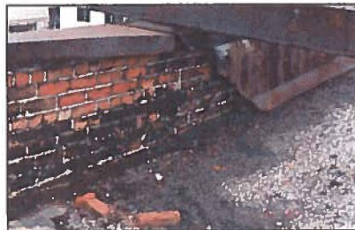
Photo # 29.- Contre-solin absent, solin de membrane déchiré;
