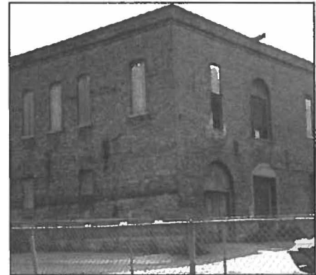
Photo # 11.- Arrière de l'immeuble (fondations exposées sans protections contre les infiltrations d'eau.)
