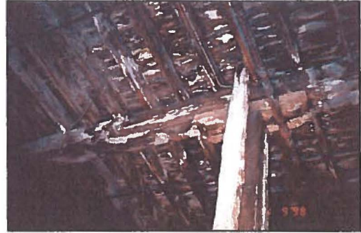
Photo # 24.- Charpente de la section D pourrie (Poutre, colonne, solives de toit);
