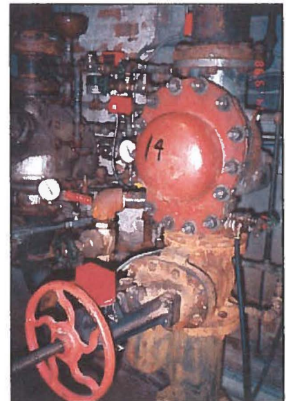
Photo # 8.- Valve d'alarme principale, Système 1960
