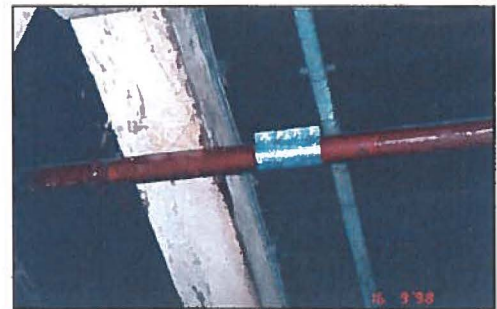
Photo # 36.- Bagues à compression (réparation temporaire);
