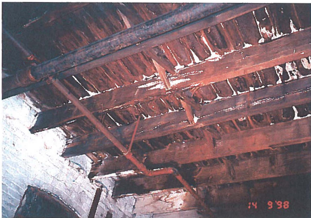
Photo 19: Section D: détails du toit (pourriture avancée).
