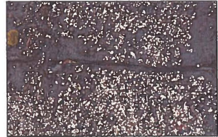
Photo # 26.- Fissure traversant tous les plis de la membrane du toit;
