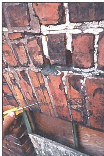
Photo # 10.- Fenêtre non étanche aux intempéries
