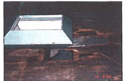
Photo # 20.- Trous dans le plancher du deuxième - Section B
