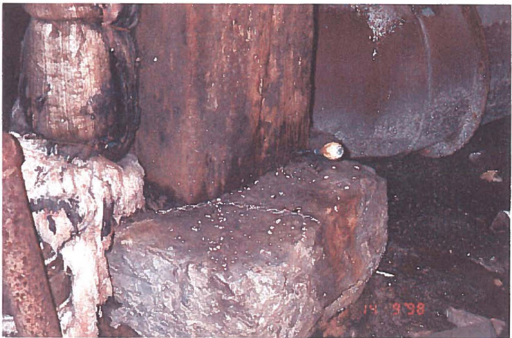
Photo 18: section D: colonne principale pourrie à la base.
