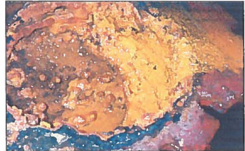
Photo # 37.- Intérieur du couvercle de la valve d'alarme 1960 - Boue et incrustations solides apparente - Notez l'absence de clapet de retenue pour la valve d'alarme (celle qui s'est refermée sur elle même);
