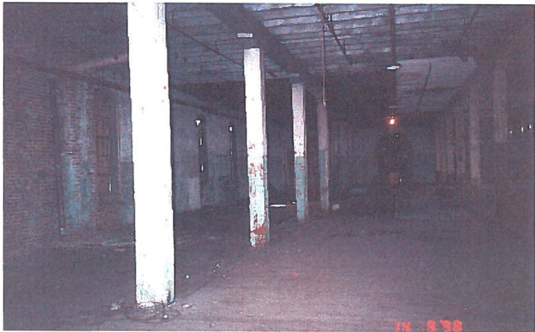
Photo 15: Section B, deuxième étage, garde corps à installer, moitié Est planchers pourris.
