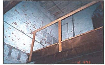
Photo # 19.- Section A, mezzanine avec garde-corps dangereux;
